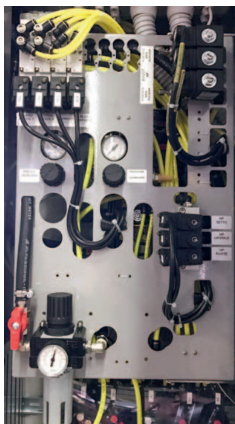
Le elettrovalvole e gli FRL Aignep provvedono all'apertura e alla chiusura dei circuiti nella gestione dell'acqua dell'impianto
